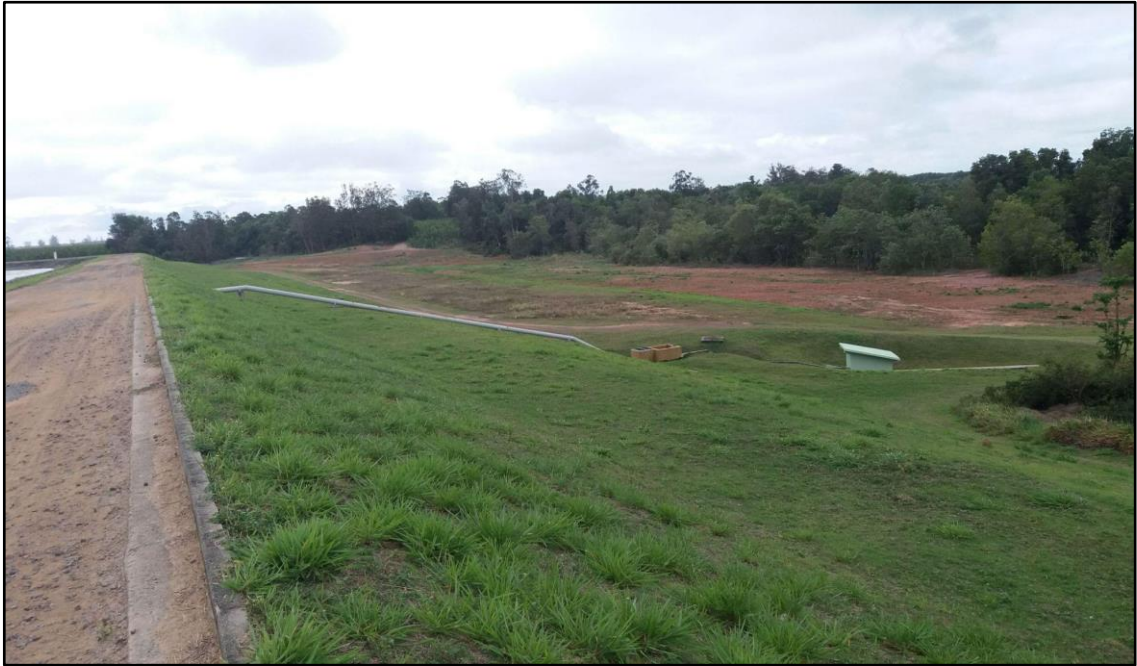
Foto 6 — Percurso da tubulação para a ETA do Serviço Autônomo de Água e Esgoto de Aracruz (SAAE). Autoria: Daniela Aguilari, 2019.
