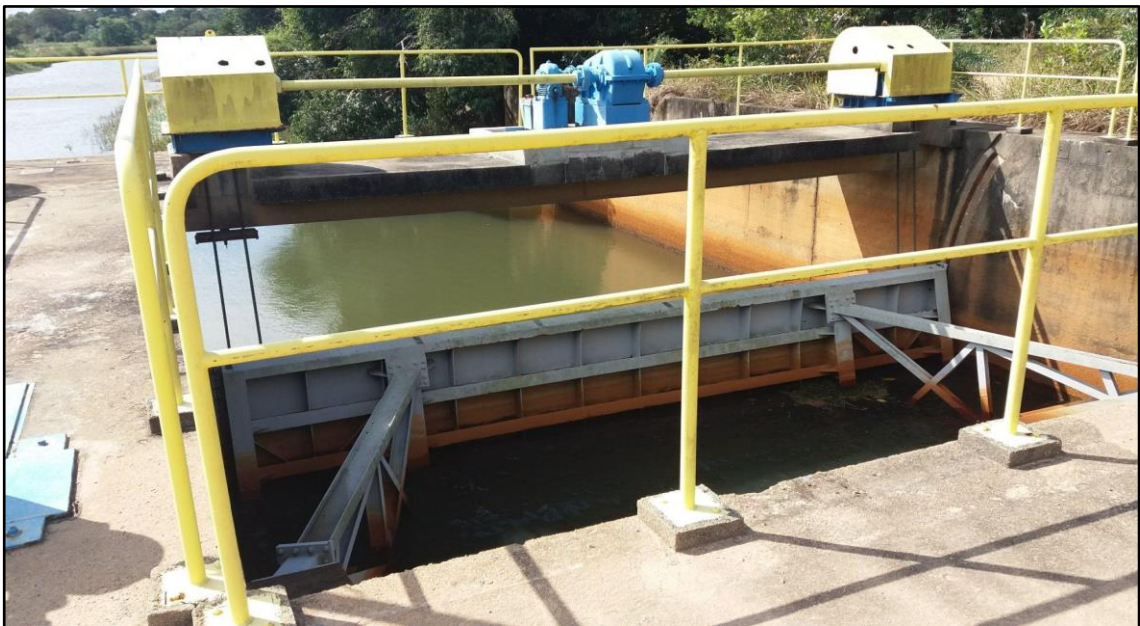
Foto 2 e 3 — Estrutura para sucção e bombeamento da água do rio Riacho, comportas para represamento e utilização das águas por parte da Suzano. Autoria: Daniela Aguilar, 2019.
