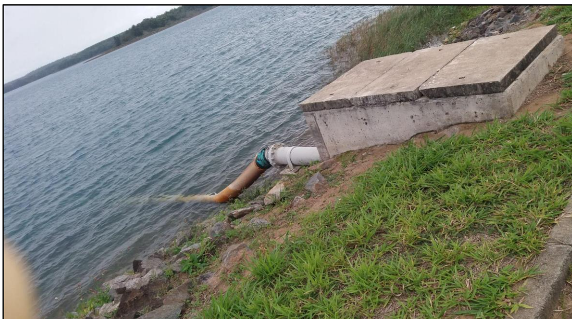
Foto 5 — Sistema de captação da água que será destinada à Barra do Riacho, para estação de tratamento. Autoria: Daniela Aguilar, 2019.
