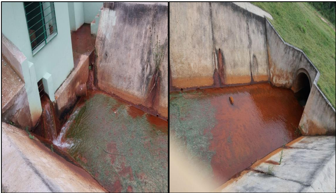
Foto 7 e 8 — Entrada e saída da água na ETA do Serviço Autônomo de Água e Esgoto de Aracruz (SAAE). Autoria: Daniela Aguilari, 2019.
