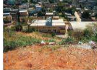
Vista da escola, ameaçada de atingimento pela movimentação de material a montante
