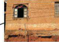
Trincas na casa, denotando movimentação do terreno (rastejo)
