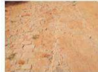
Trinca no terreno, refletida no calçamento da rua
