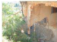
Casa destruída por deslizamento de encosta
