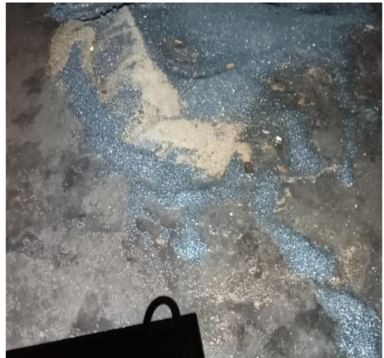
Material depositado no interior do reservatório
