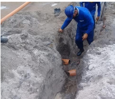
Reparo em rede sem realizar o processo de desinfecção
