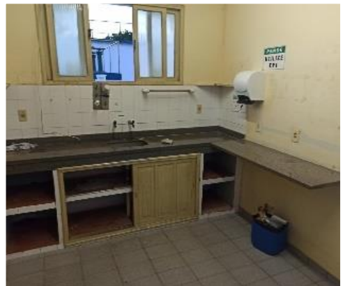
Laboratório da ETA em estado precário
