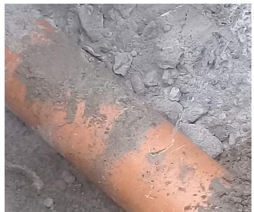
Material inadequado usado na rede de água
