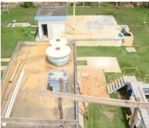
Tanques inadequados em locais de difícil acesso
