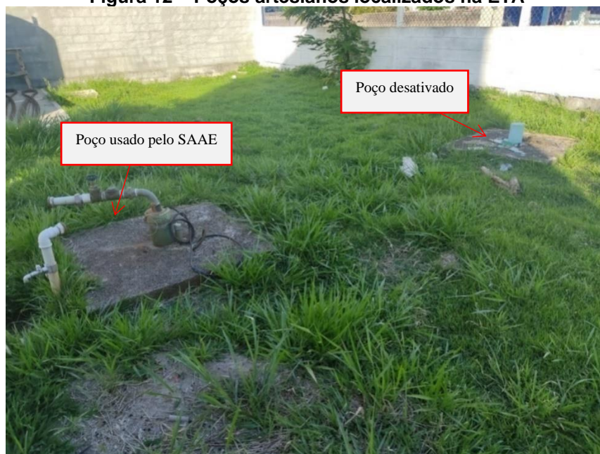
Figura 12 – Poços artesianos localizados na ETA
