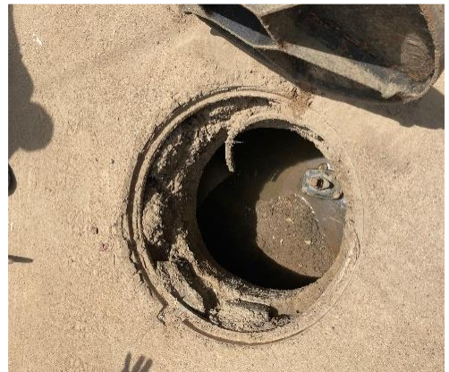
Acumulo de sedimentos
