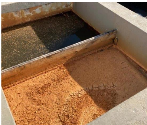
Floculador com excesso de coagulante
