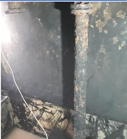
Válvula de pé em estado de corrosão avançada
