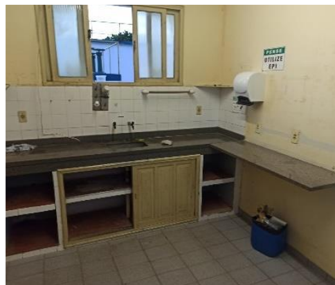
Ausência do monitoramento da água decantada no laboratório
