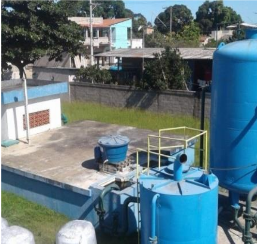
Reservatório sem duto de ventilação
