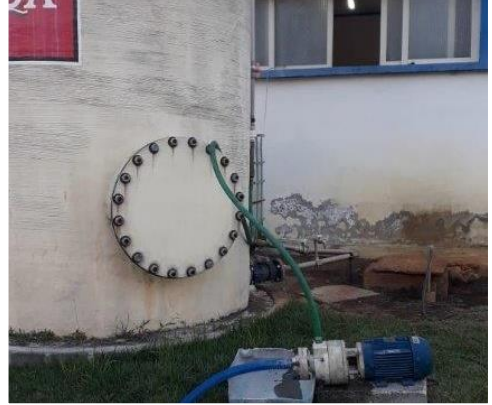
Tanques sem contenção de vazamento de produtos
