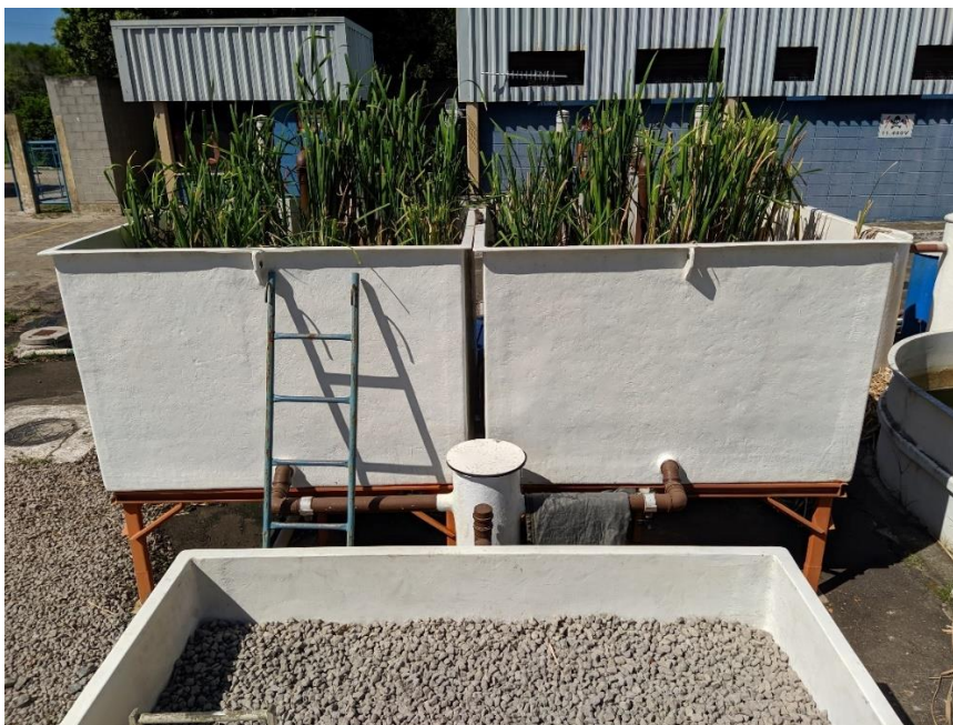
FIGURA 7: ILUSTRAÇÃO DOS RESERVATÓRIOS DO WF. FONTE: PRÓPRIO AUTOR.
