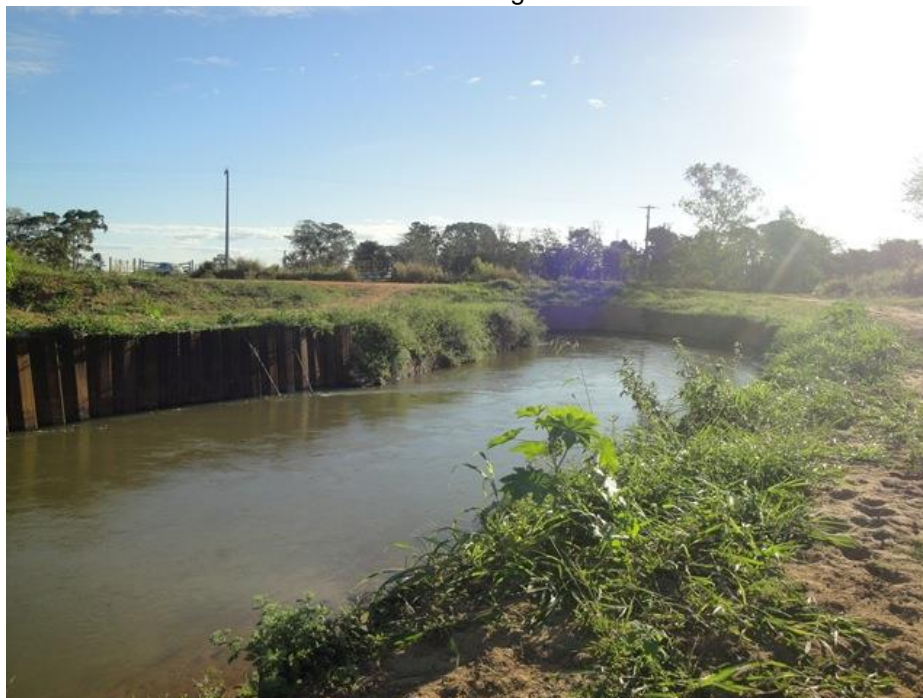
Figura 33 - Canal Caboclo Bernardo, onde observa-se a presença de barras metálicas para conter a erosão das margens.
