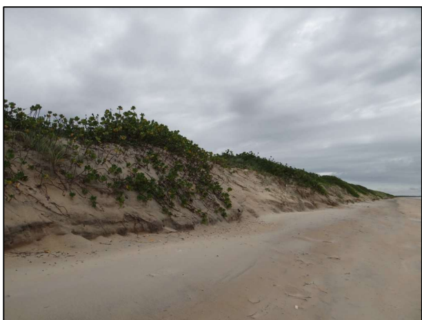
Figura 23 – Erosão na porção frontal da duna com erradicação da Formação Herbácea não Inundável na APA Conceição da Barra-ES.
