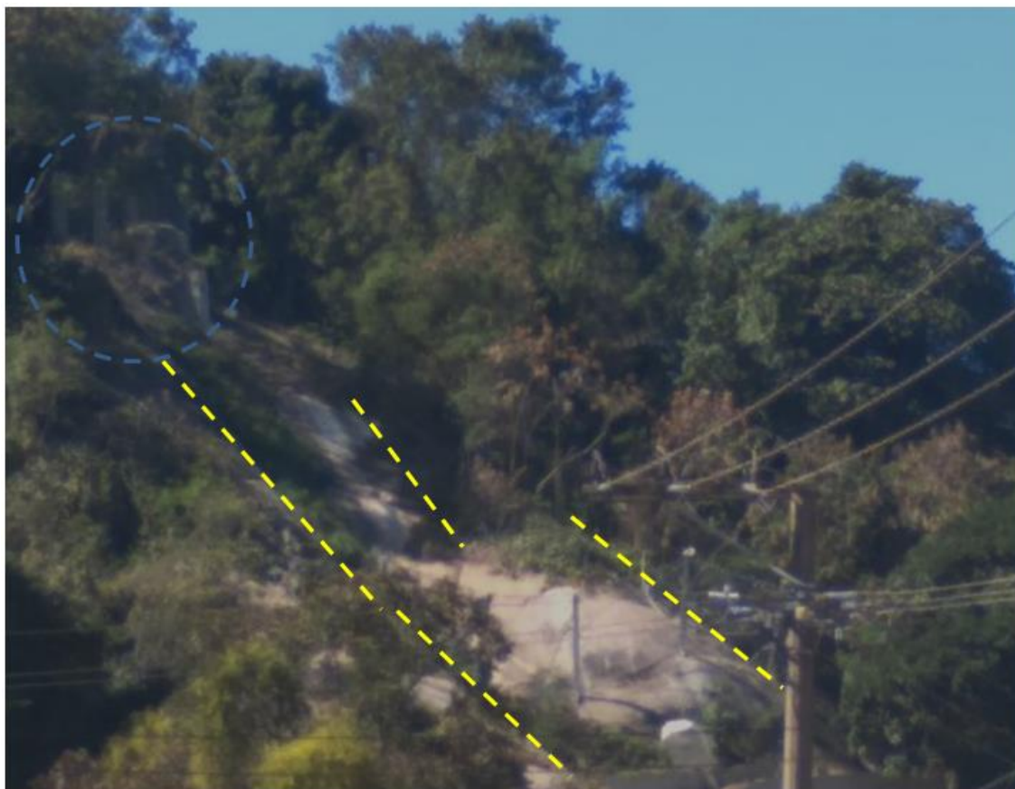
Figura 47 – Obra de contenção (circulada em azul) em encosta com fraturas expressivas (linhas amarelas) de orientação NE-SW.
