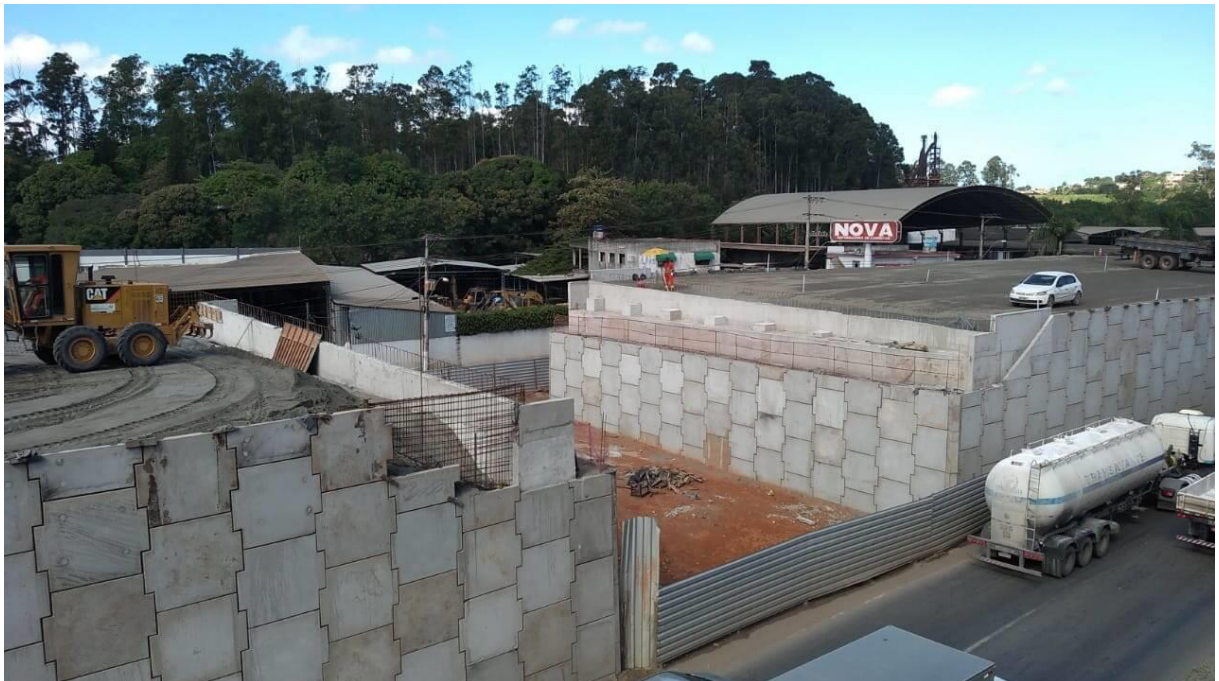
Figura 3.16. Um dos viadutos sendo construídos nas proximidades do Bairro Marcílio de Noronha em Viana.
