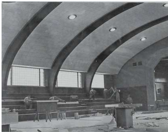
Figura 2 - Ginásio em Pesthigo, no estado de Wisconsin, com pórticos de 19,5 metros de vão em elementos curvos de MLC.
