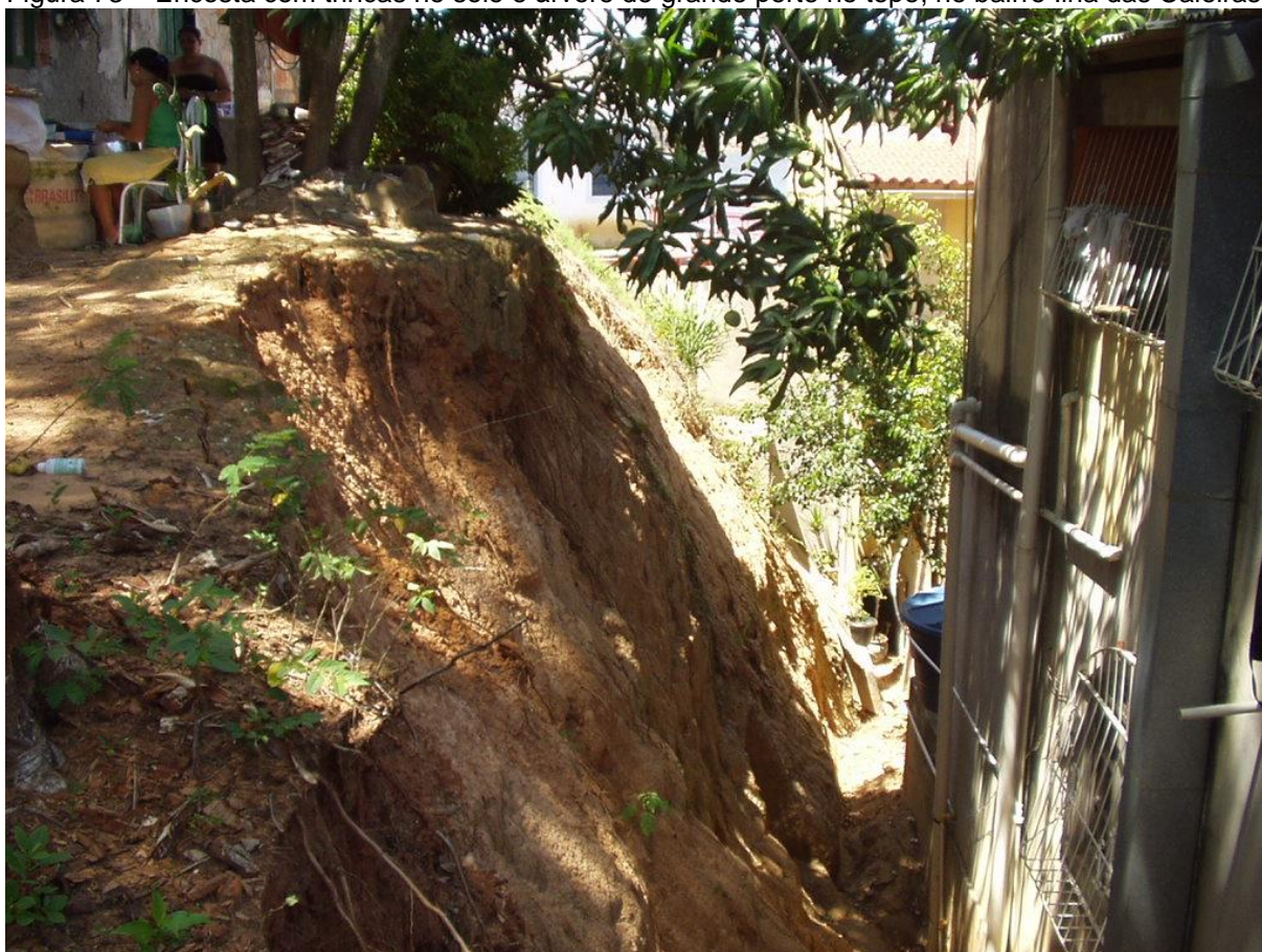
Figura 73 – Encosta com trincas no solo e árvore de grande porte no topo, no bairro Ilha das Caieiras.
