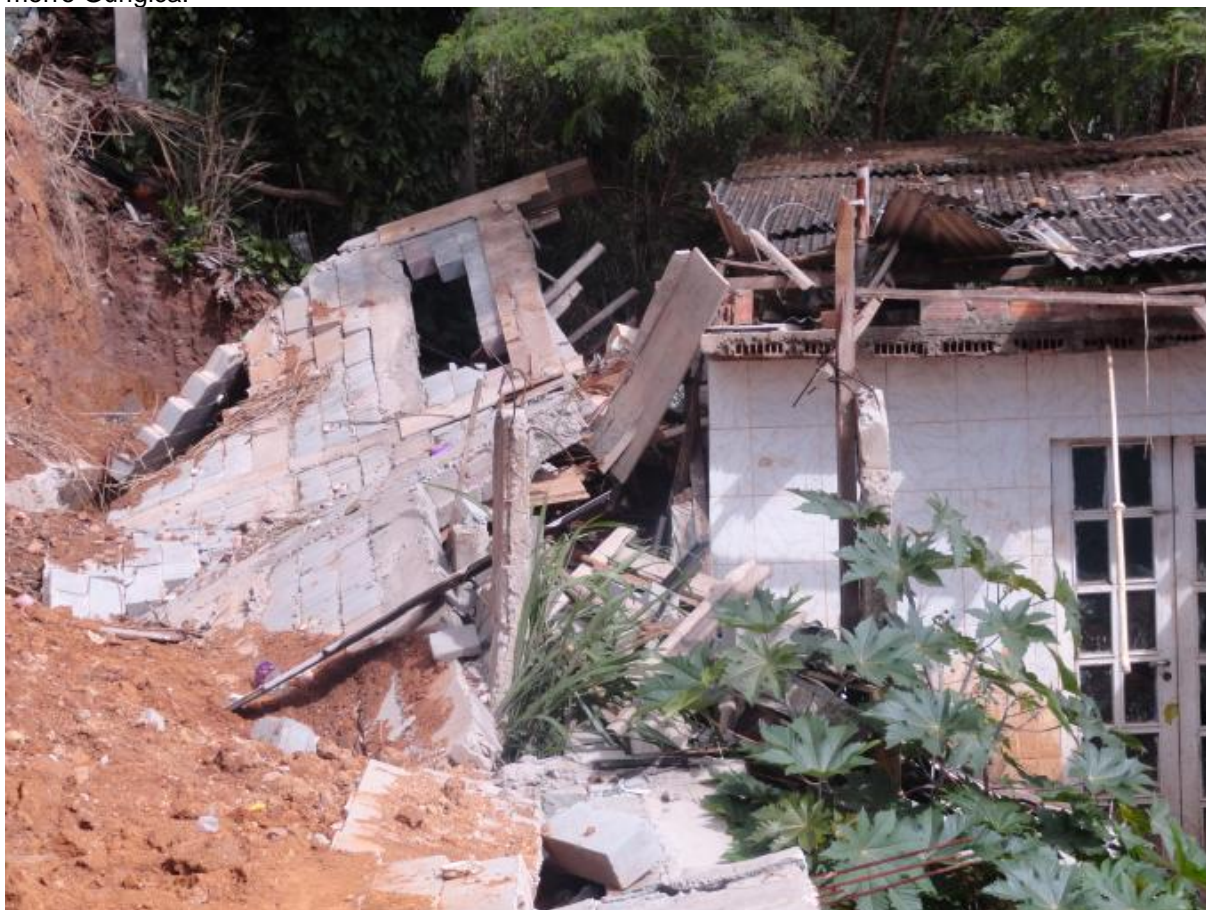
Figura 83 – Muro tombado em igreja causado por escorregamento translacional em talude de corte no morro Gurigica.
