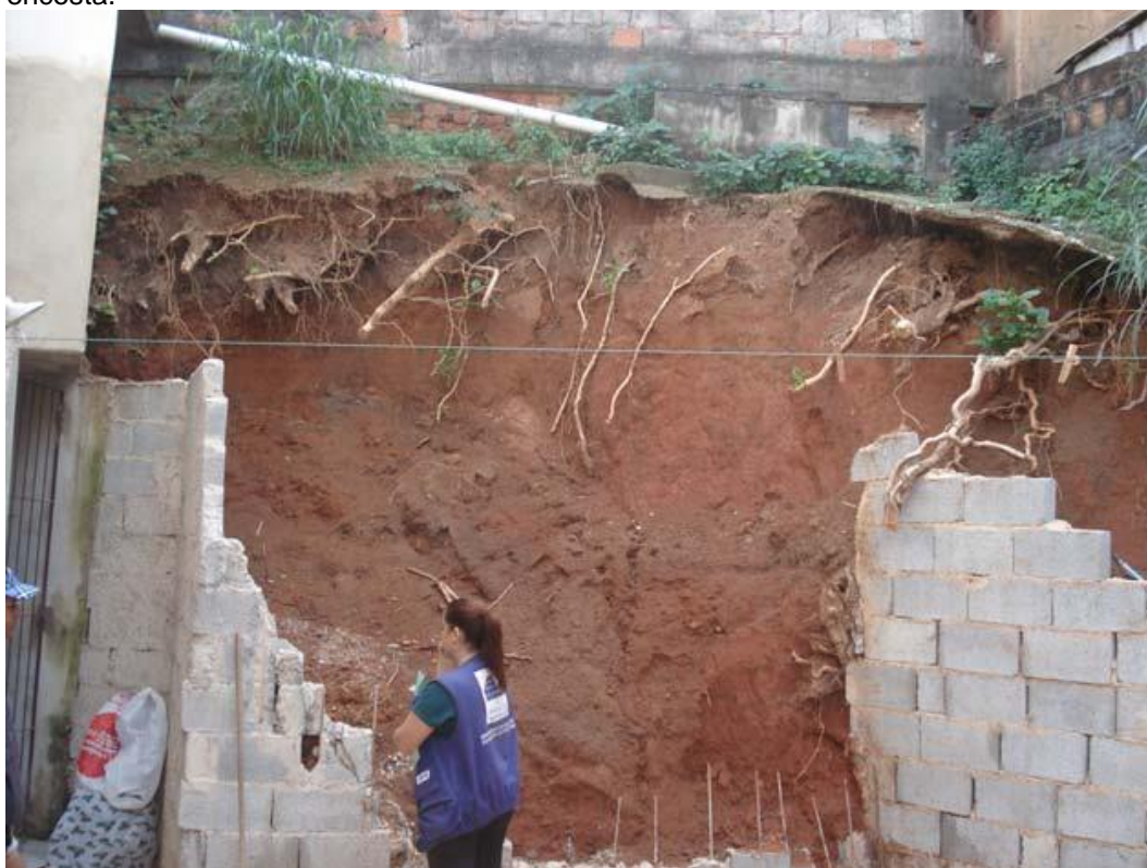
Figura 56 – Escorregamento translacional causado por rompimento de tubulações a montante da encosta.
