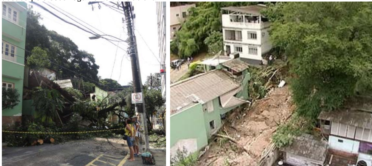
Figura 77 – Visão lateral do restaurante Sol da Terra (laudo 011/2003) e visão aérea da destruição causada pelo escorregamento translacional.
