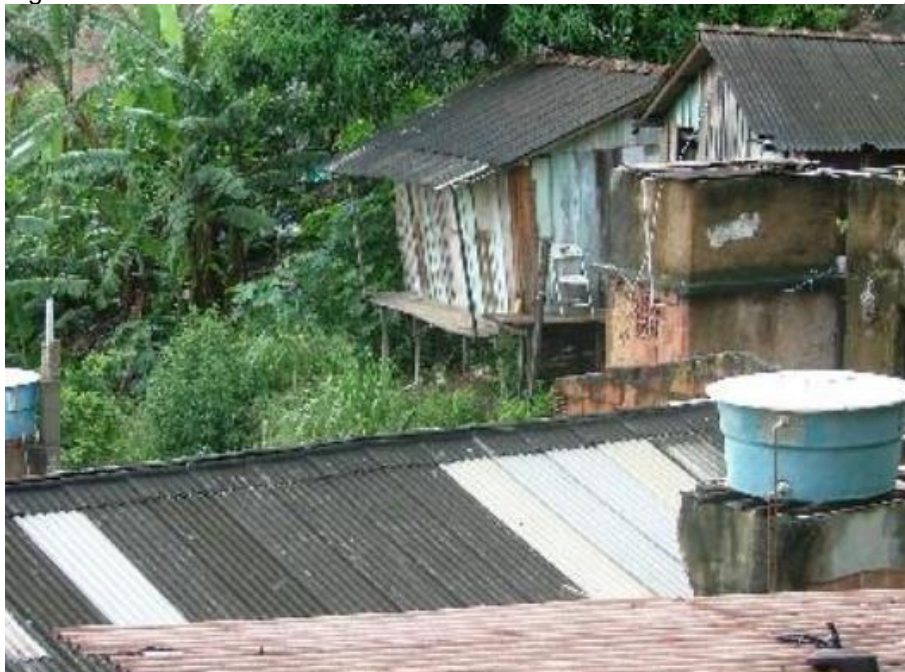
Figura 9 – Casa inclinada no bairro Forte São João em decorrência de rastejo.
