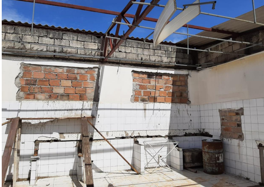
Fotografia 19 - Casa saqueada sem telhado em Bento Antigo
