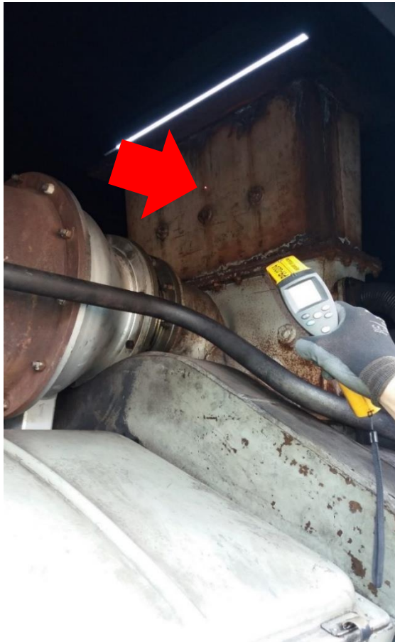
Figura 25 – Medição da temperatura dos gases (saída da turbina)
