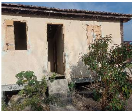
Fotografia 12 - Casa de alvenaria mais antiga (desocupada). Zona rural de Sooretama, ano de 2022.
