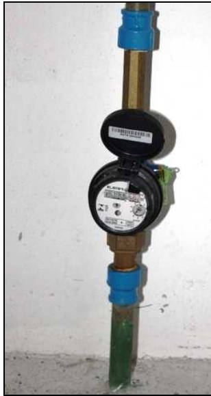
Figura 32: Hidrômetro do térreo
