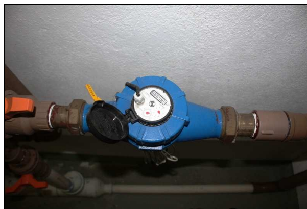
Figura 28: Hidrômetro no extravasor da caixa de entrada
