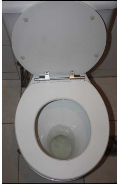
Figura 65: Água de reúso na bacia sanitária
