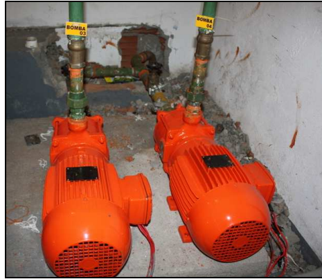
Figura 27: Bombas de recalque
