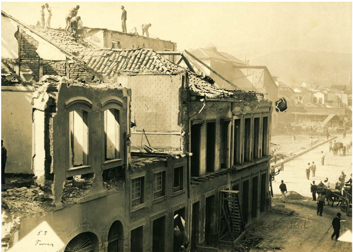
FIGURA 10: Demolição de Cortiços Demolição de cortiços para início das obras da Avenida Central. Fonte: João Martins Torres, década de 1900.
