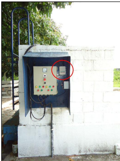
Figura 33 – Unidade responsável pelo monitoramento de temperatura ambiente, umidade relativa do ar e corrente elétrica da bomba de recirculação interna.
