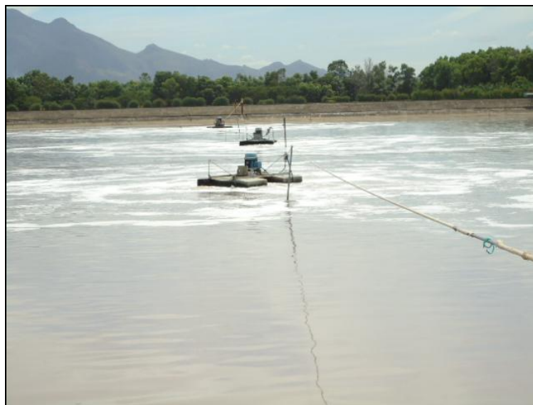
Figura 1 – Aeradores superficiais instalados na lagoa de tratamento de esgoto.
