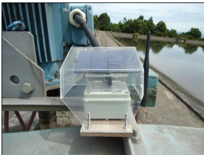
Figura 31 – Suporte de acrílico para proteção contra chuvas.
