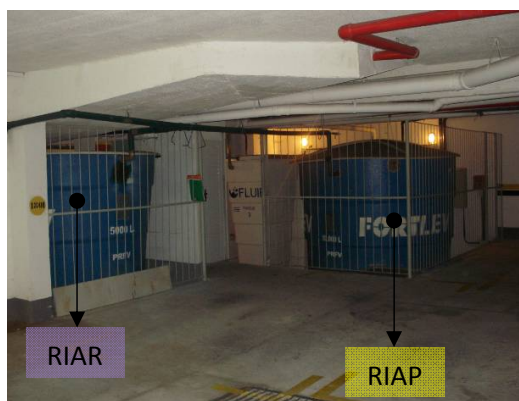
Figura 14: Vista geral das cisternas e da ETAC, no subsolo.
