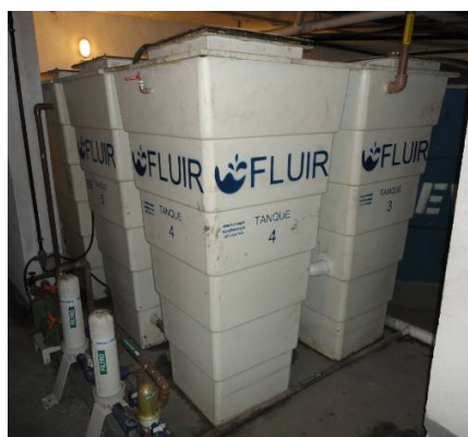
Figura 13: Vista geral da ETAC, no subsolo.
