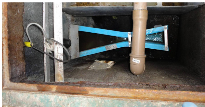
Figura 40: Calha parshall e sensor de nível ultrassônico.
