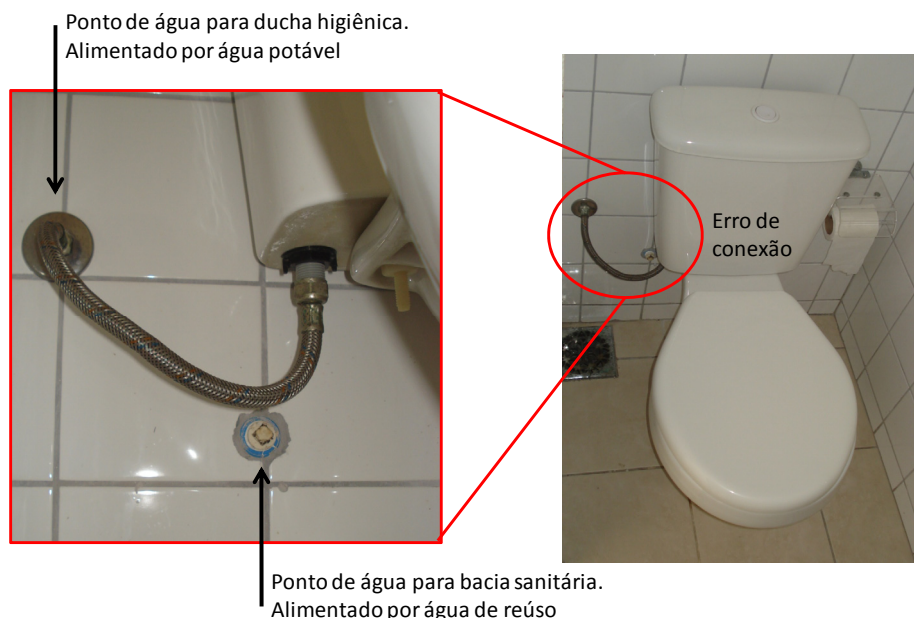
Figura 16: Bacia sanitária com erro de conexão.
