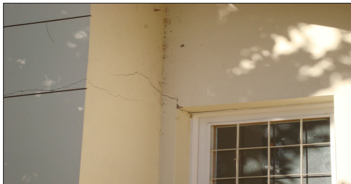
Figura 43: Rachadura em outra casa localizada na avenida principal da nova cidade. Fonte: Priscila Costa (2010).
