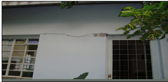
Figura 42: Rachaduras numa casa da principal avenida da nova Itueta. Fonte: Priscila Costa (2010).
