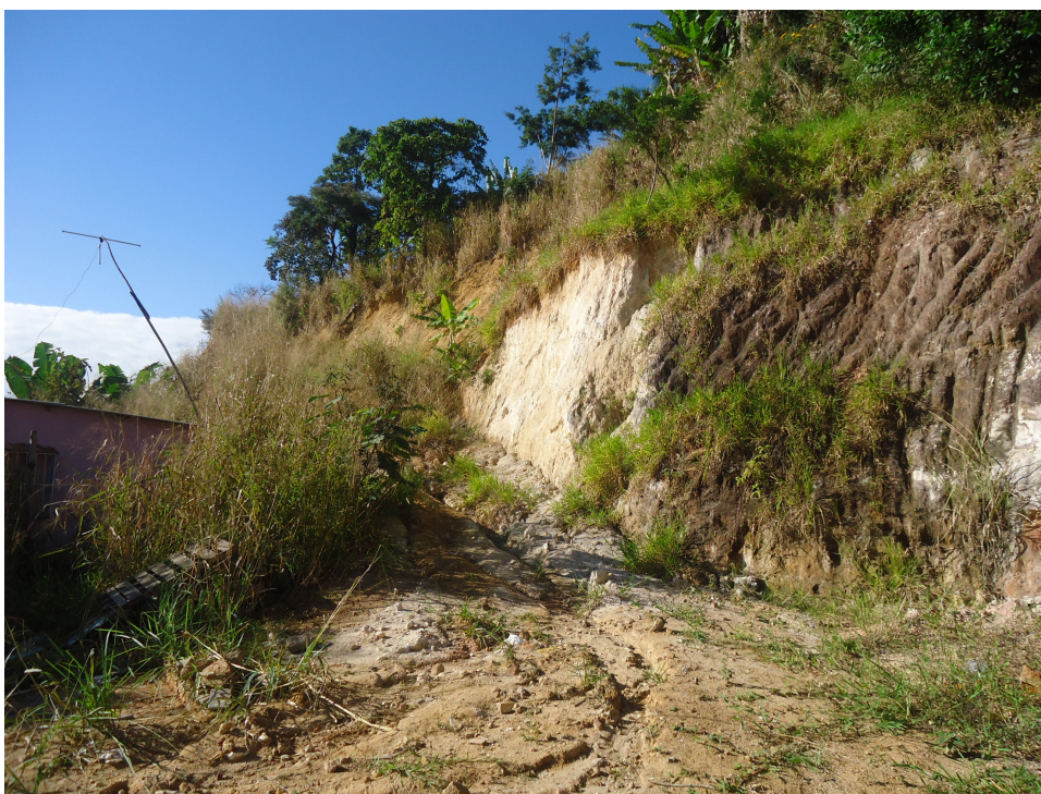
Figura 16. Indícios de deslizamento de encosta (Foto do autor, maio de 2011).
