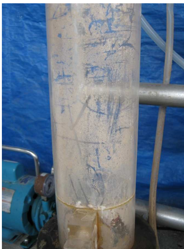
Figura 51. Incrustação nas paredes internas da torre de arraste.
