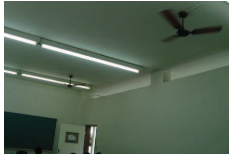
Foto 5 – Dois dos quatro ventiladores e abertura na parede
