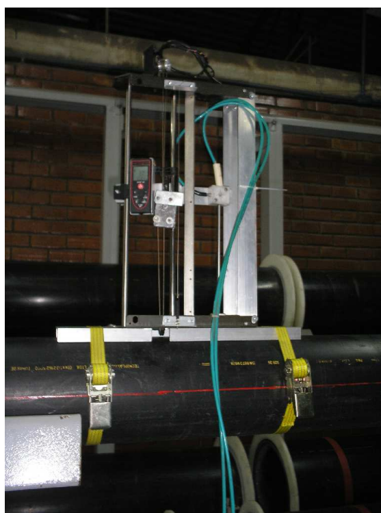
Figura 3.11 – Vista “as built” do Projeto do conjunto fixador do Tubo de Pitot.
