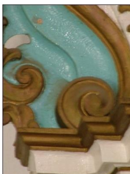
Figura 41 – Detalhe do arco do camarim do retábulo de Nossa Senhora do Rosário. Foto: Rachel Diniz Ferreira, 2006.
