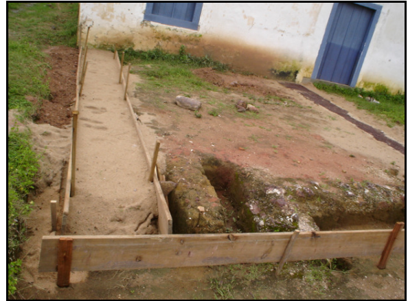
Fig. 53. Fundações da antiga cozinha. Na ocasião eram realizadas as proteções de cimento sob as fundações encontradas. Fonte: Foto da autora.
