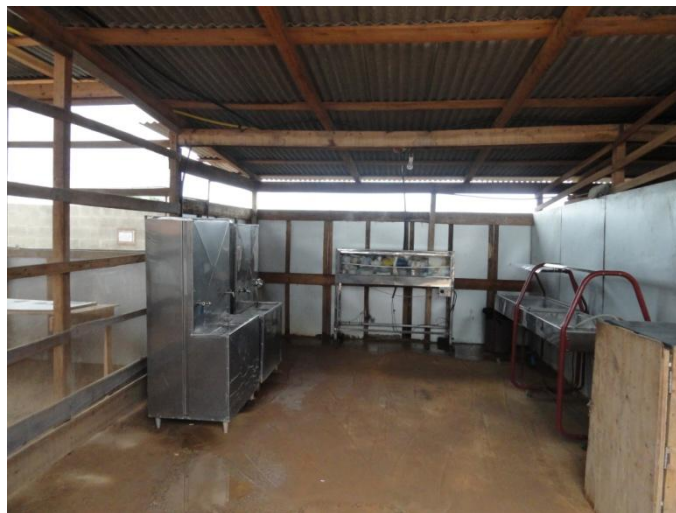
Fotografia 4.9 – Bebedouro instalado no anexo do refeitório da empresa B.
