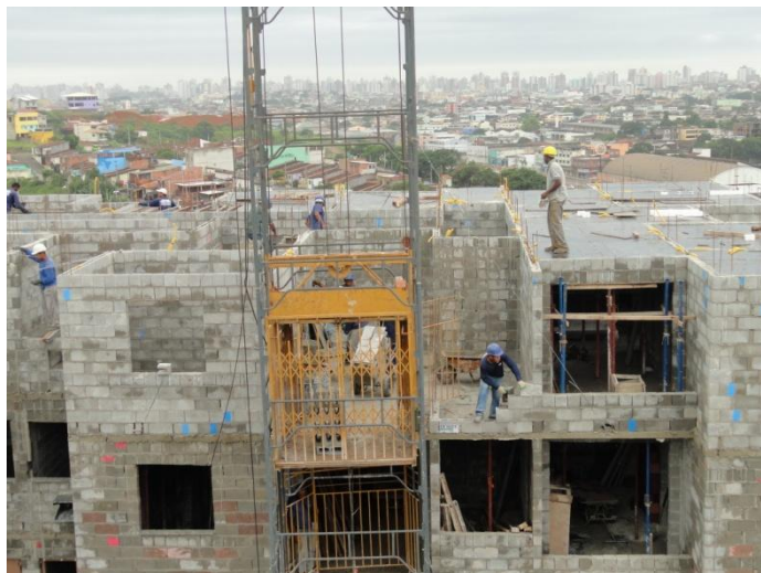
Fotografia 4.13 – Obra acima de 2m da empresa B: trabalhadores sem cinto de segurança.
