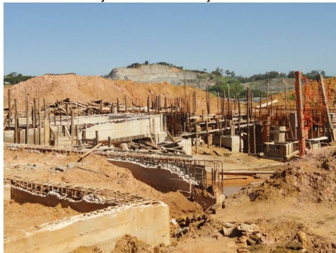
Fotografia 4.3 – Área de fundações sem sinalização de advertência e sem isolamento.
