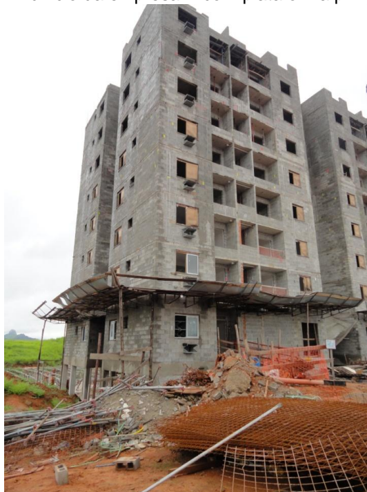
Fotografia 4.4 – Edifício da empresa B com plataforma principal danificada.
