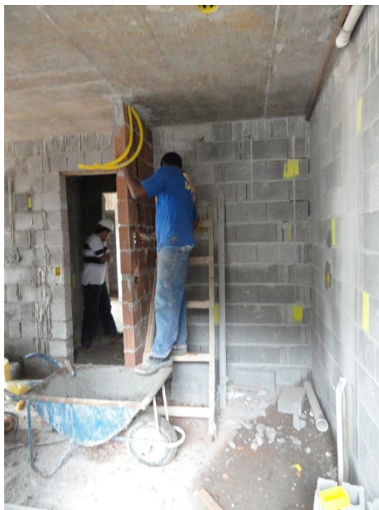
Fotografia 4.18 – Escada de abrir em uso incorreto na obra da empresa B.
