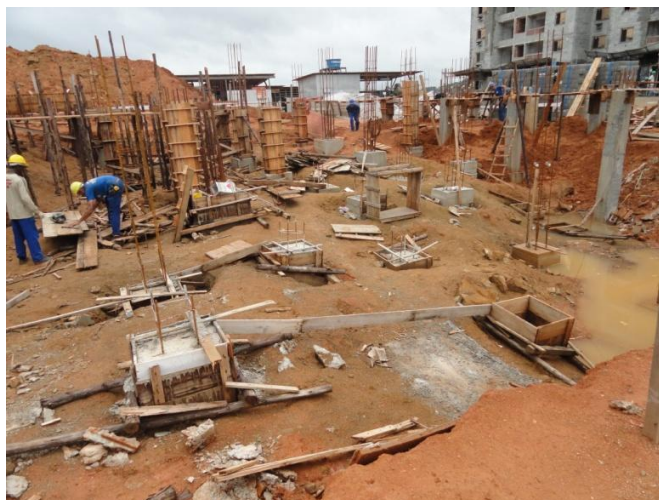
Fotografia 4.11 – Área de obra da empresa B sem proteção nas pontas dos vergalhões.
