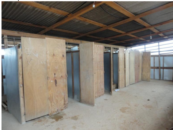
Fotografia 4.20 – Empresa B: Sanitário da obra sem trincos nos boxes e faltam lâmpadas.
