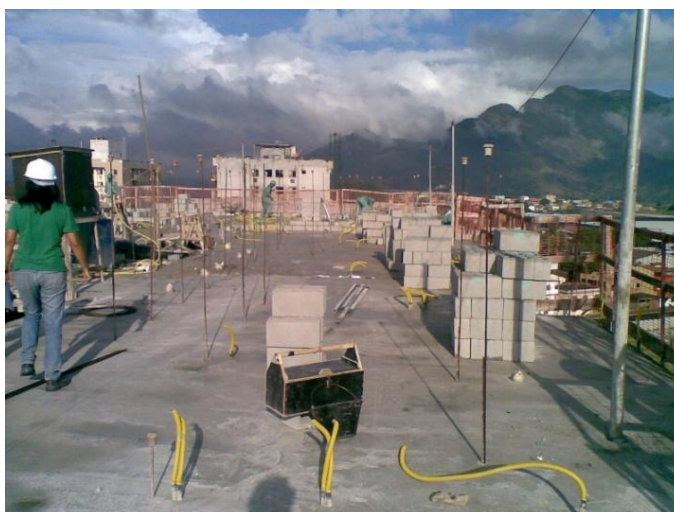
Fotografia 4.6 – Laje do edifício da empresa C com linha de vida e guarda-corpo de periferia.
