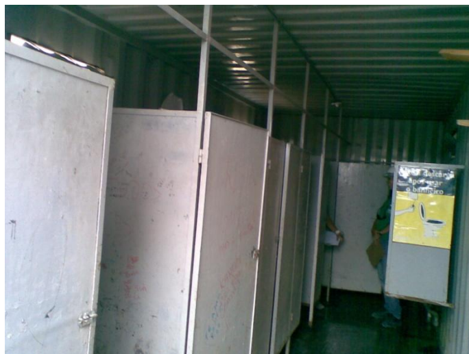
Fotografia 4.21 – Sanitário da obra da empresa C, em contêiner, de iluminação insuficiente.
