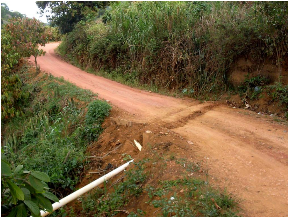
Figura 23 – Tubos de PVC para captação do escoamento no trecho de maior uso.
