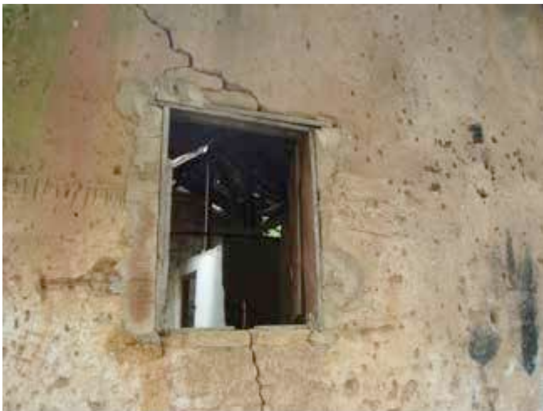
foto 55: casa em ruína
