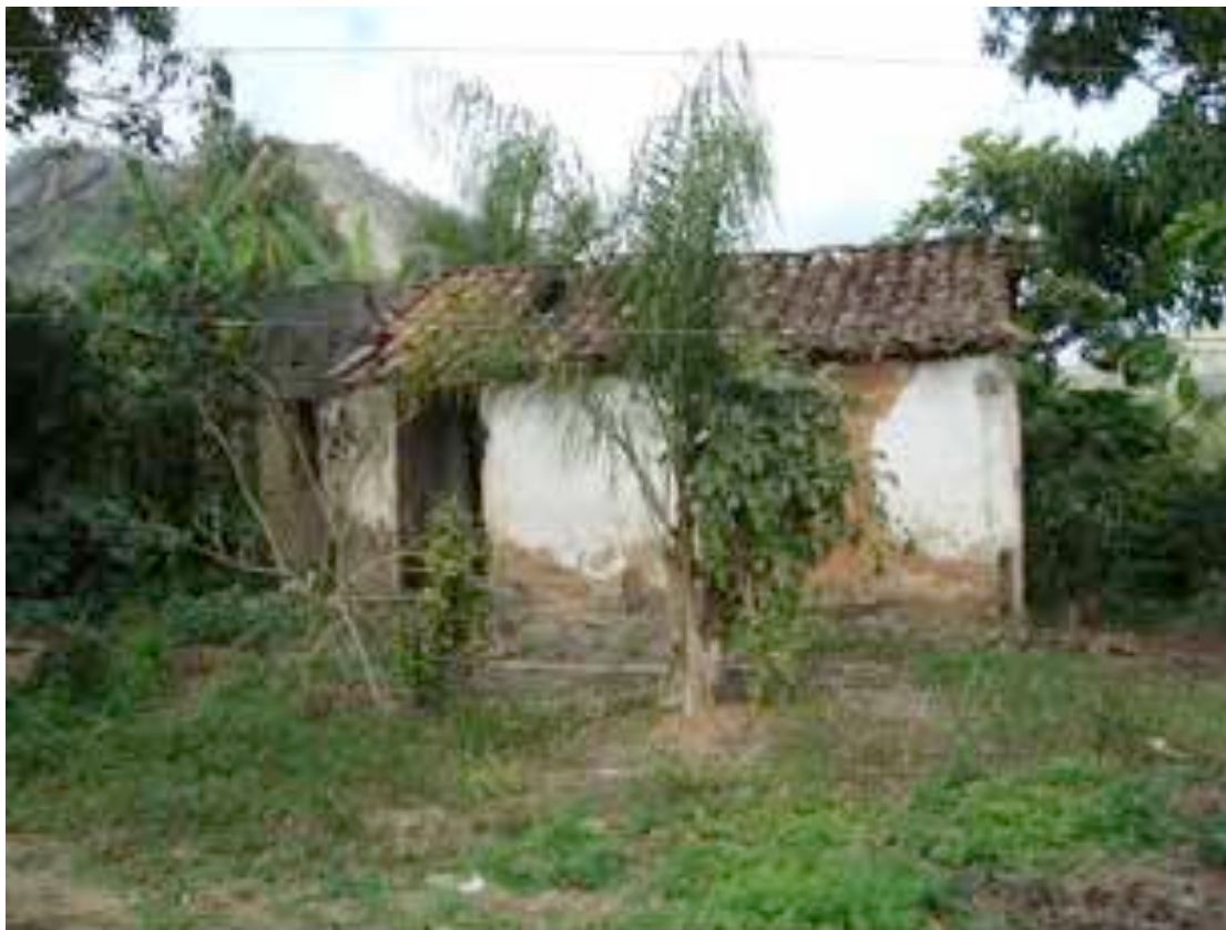
foto 56: casa em ruína
