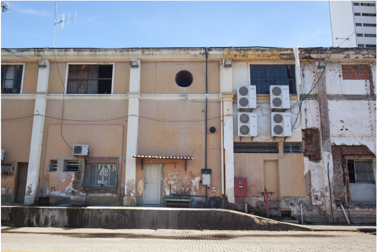
Figura 3 – Armazéns 1 - Adaptações elétricas.
