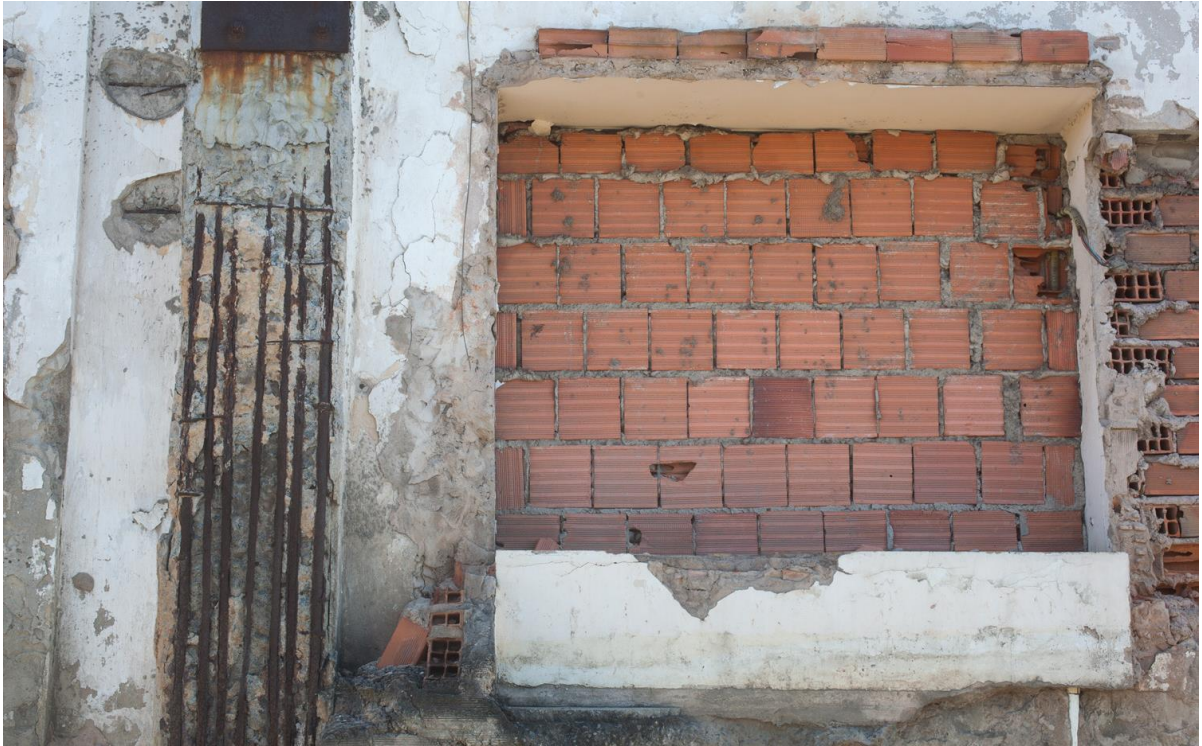
Figura 5 - Exposição da estrutura e dos tijolos de uma janela do Armazém 1.
