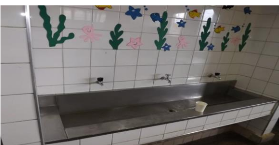
Lavatório do refeitório
