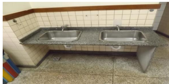
Lavatório do refeitório
