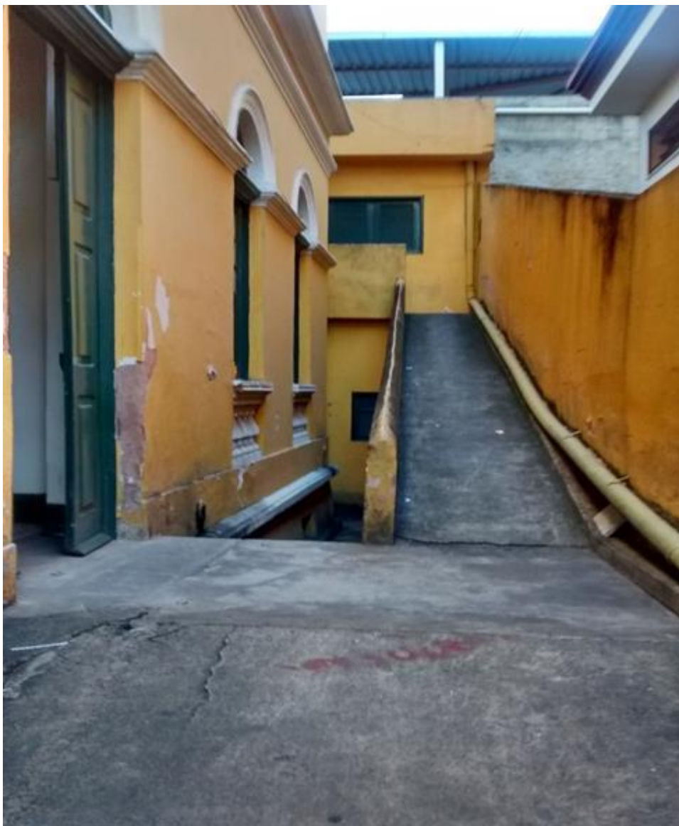
Foto 3 – Rampa de acesso às salas no andar de cima, sanitários e secretaria, embaixo
