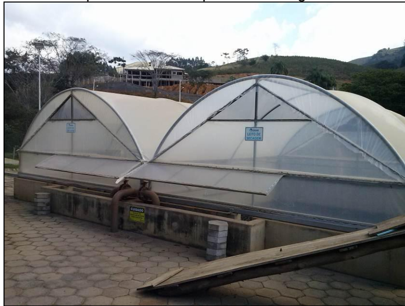
Figura 10 – Vista das estufas para reter o calor proveniente da queima do biogás.
