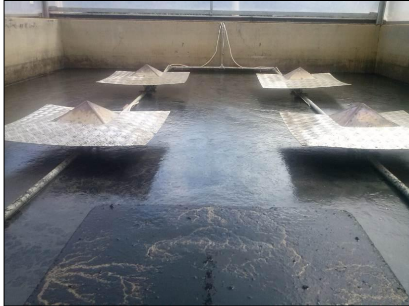
Figura 12 - Vista interna da estufa referente ao Leito 2 após a descarga do lodo líquido de 15 cm.
