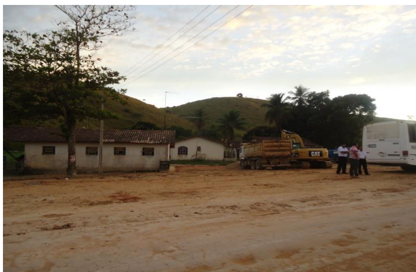
Figura 16 – A “Casa de Tábua”, atrás deste trator. Em 2014, a terraplanagem soterrou-a de vez e com ela um dos ícones que representava a saga de Udelino
