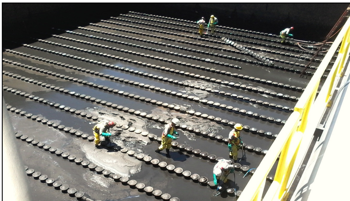
Figura 45 – Parte interna do reator de aerção “C” da ETE Araçás durante um período de manutenção corretiva com destaque para os difusores de ar instalados no fundo.
