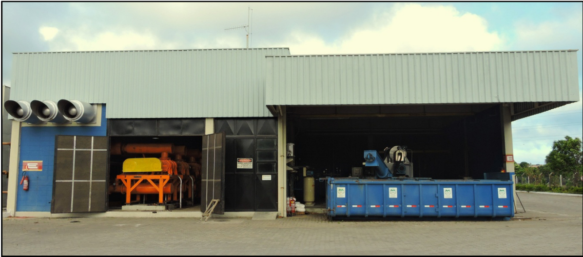
Figura 33 – A esquerda o galpão dos sopradores e a direita o galpão de geração de lodo úmido pela centrífuga com a caçamba de armazenamento na ETE Araçás. Fonte: Produção do próprio autor.
