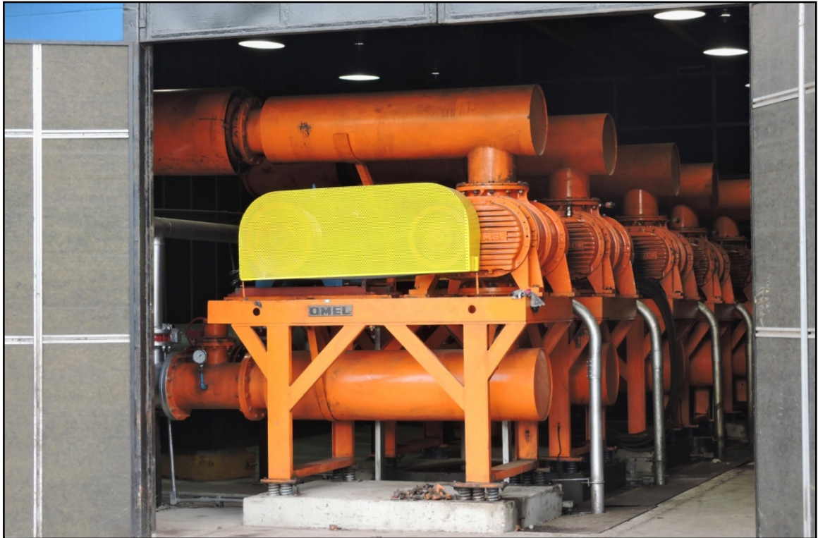
Figura 28 – Galpão dos sopradores da ETE Araçás, local que foi realizado as medições de temperatura e termografia.
