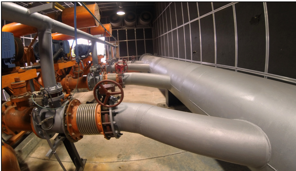
Figura 44 – Na seqüência da direita para a esquerda, barrilete, registros e válvulas, conjuntos motores sopradores da ETE Araçás.
