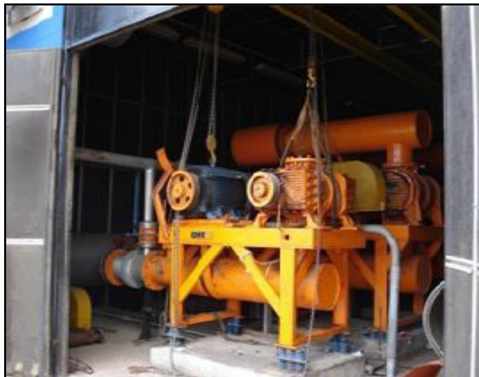
Figura 43 – Conjunto motor soprador SO-01/E durante uma manutenção corretiva na ETE Araçás.
