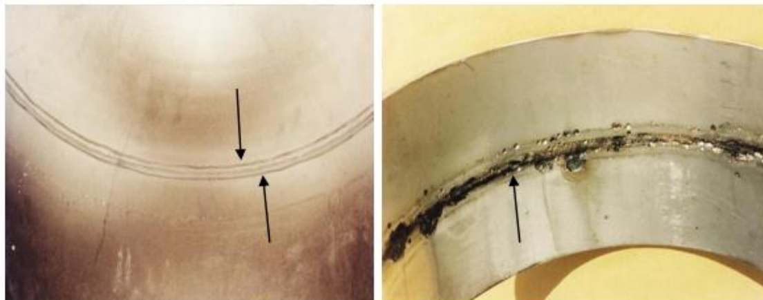
Figura 12 - Corrosão em torno do cordão de solda de um aço inoxidável (GENTIL, 1996).
