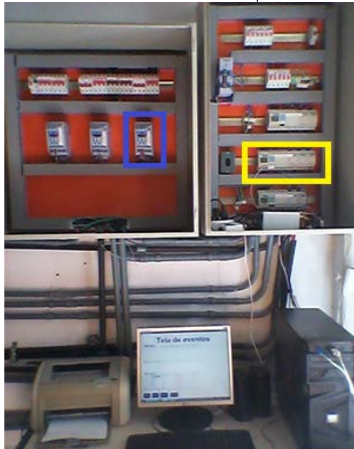
Figura 17: Automação utilizada no MBBMR, o CLP está destacado de amarelo e o inversor de frequência de azul.
