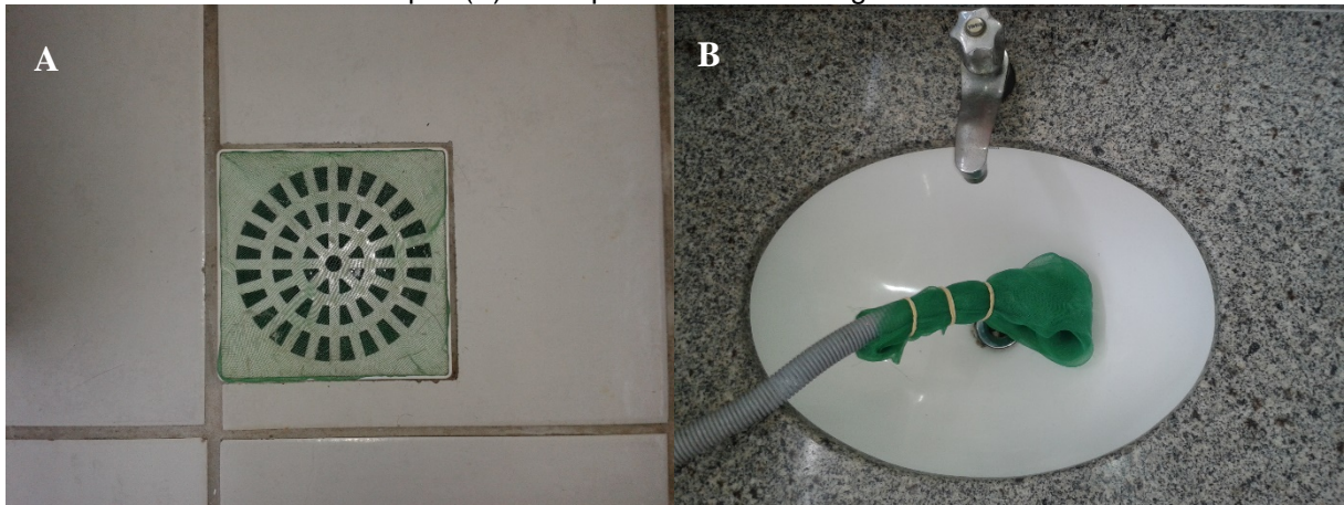
Figura 13: Tela fina instalada no ralo do banheiro (A) e na saída do efluente da máquina de lavar roupas (B) como pré-tratamento da água cinza.
