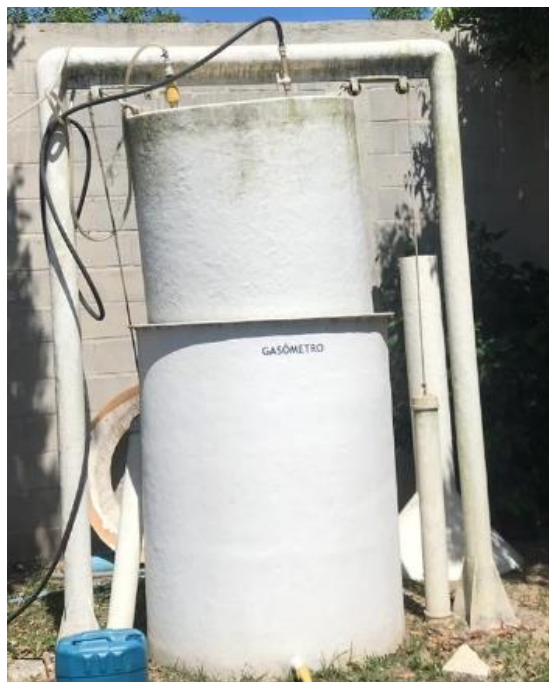
Figura 4.4 – Reservatório de biogás.
