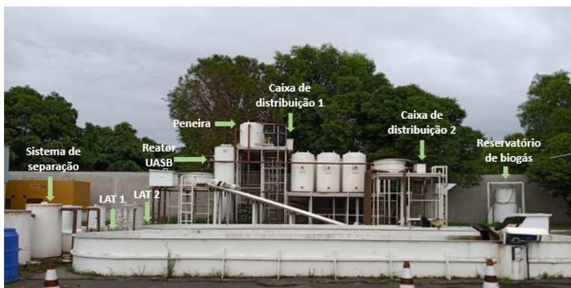
Figura 4.1 - Estação piloto de tratamento de esgoto.
