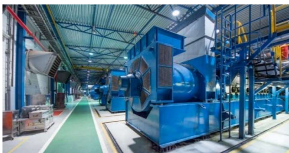
Figura 5 - Usina de geração de energia elétrica com motores Diesel.
